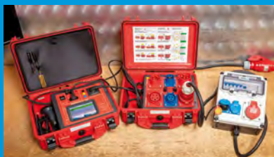
Prüfung einer mobilen Stromverteilung mit RCD
