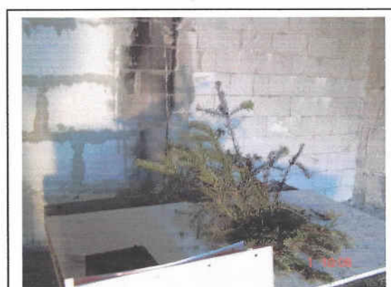
Abbildung 30: nur partielle Schädigung
