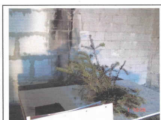
Abbildung 30: nur partielle Schädigung
